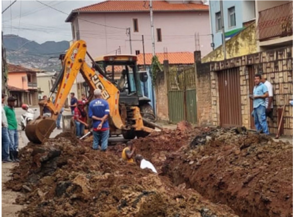
A via apresentava dois pontos de abatimento, o que prejudicava a segurança no trânsito local.
