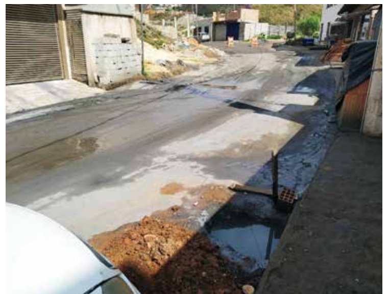
Foto após as obras. A rua fica localizada no bairro Morada do Sol.
