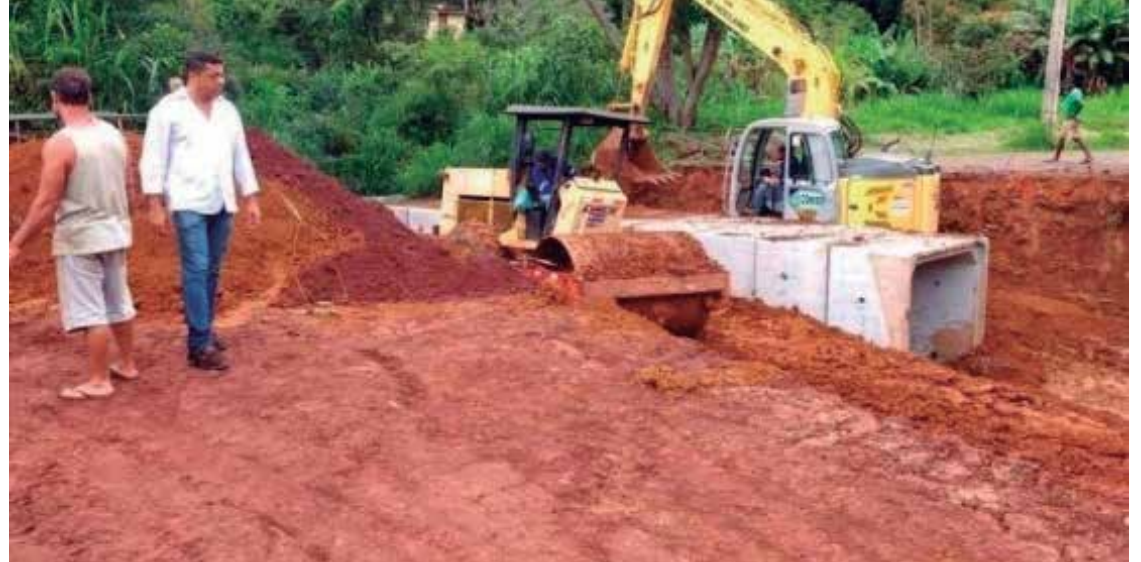
Ponte de acesso ao bairro Dom Oscar é destruída após a chuvaram de sexta-feira.
