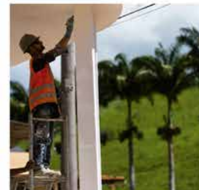
De 146 casas e estabelecimentos comerciais atingidos em Barra Longa, 82 já tiveram suas reformas concluídas e em outros 35 as obras já foram iniciadas
